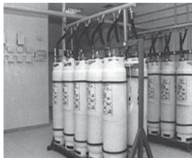
Рис. 2.51. Автоматична установка газового пожежогасіння
